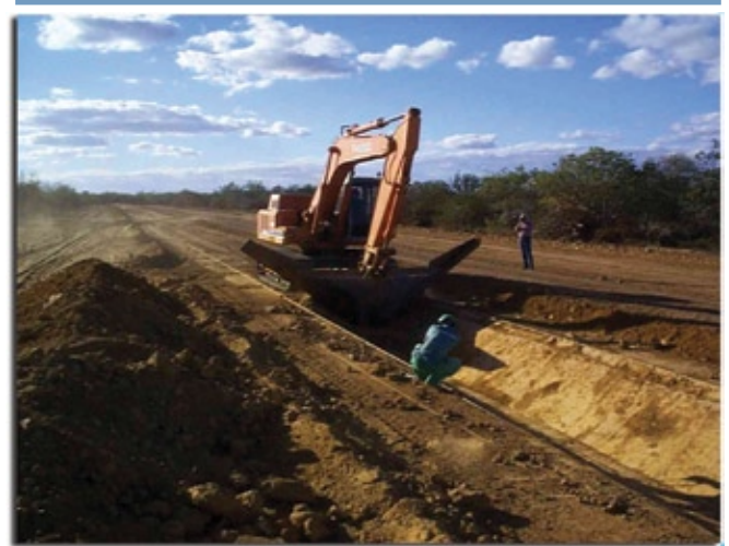
Foto 8 – Abertura de um canal com uma escavadeira Poclairn com concha de formato trapezoidal.
